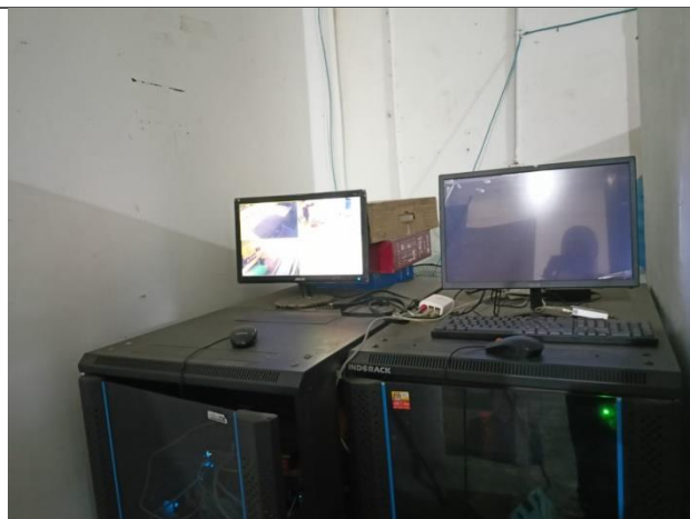
RUANG KONTROL CCTV DAN SERVER
